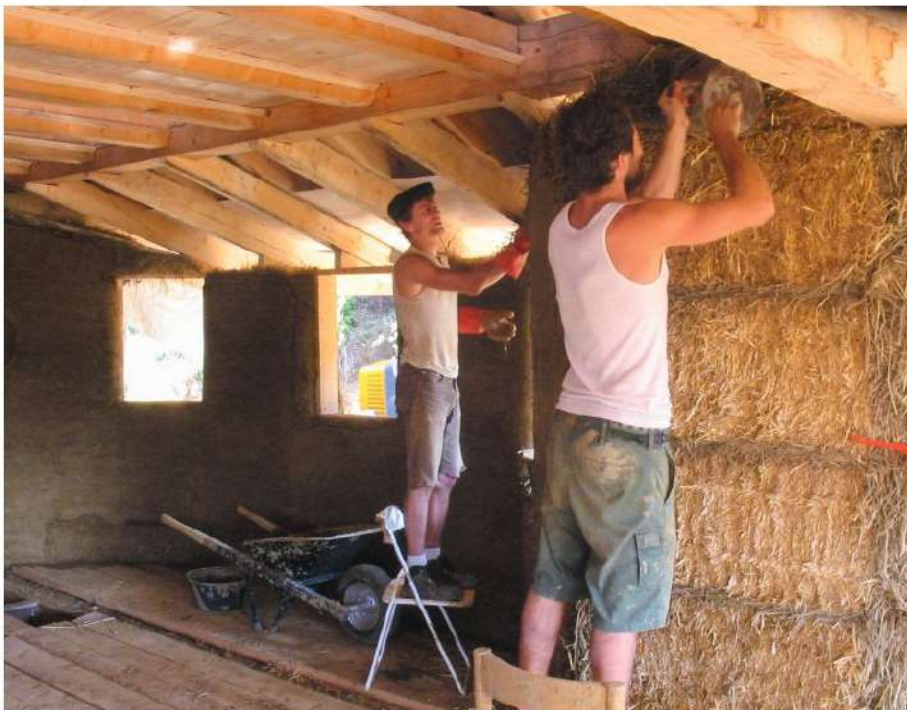
Chantier de construction de la première maison de paille de Suisse romande.
